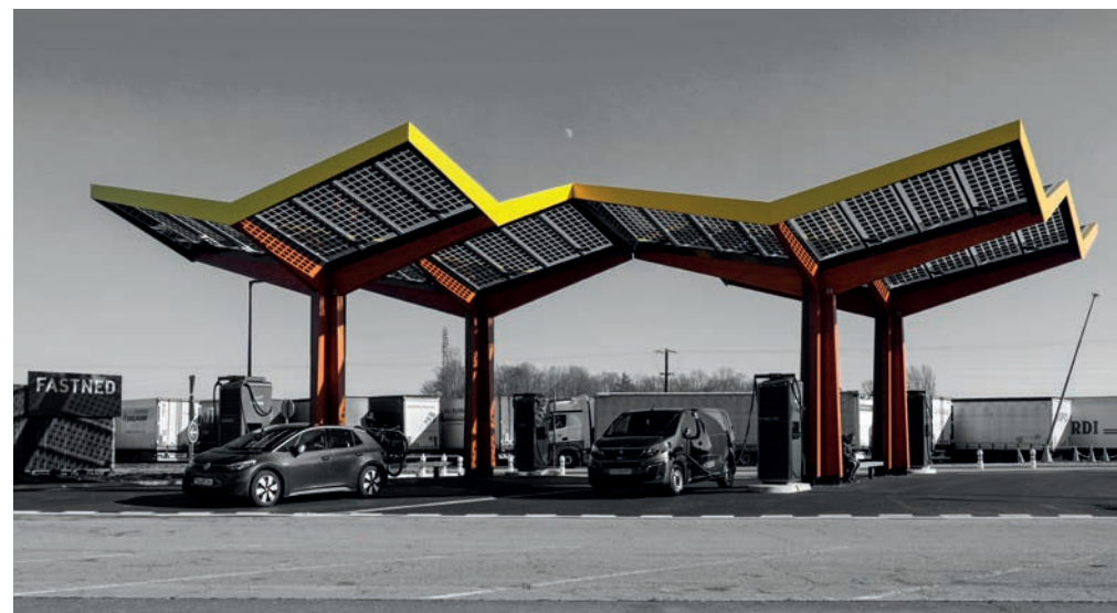
Estación con puntos de recarga eléctrica de alta potencia instalada por Fastned en Saint-Ambreuil (Drôme) en la red de autopistas de APRR-AREA
