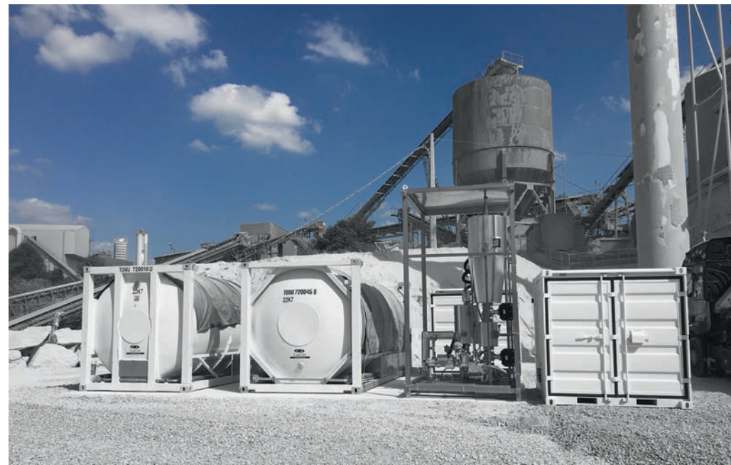
Planta de cal ubicada en Bocahut (Norte). El sistema de captura de CO 2 es el sistema al centro de la imagen. A la izquierda, se ven dos tanques de almacenamiento de CO 2 .
