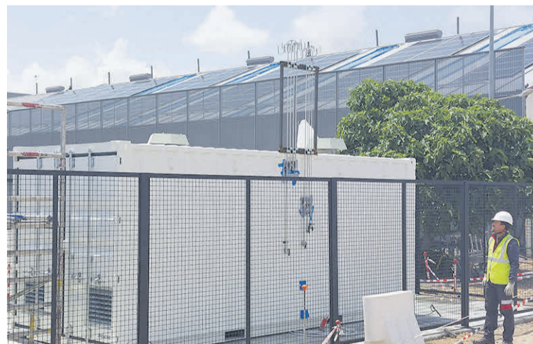
Imagen del proyecto piloto de hidrógeno verde en la sede central. / EIFFAGE
