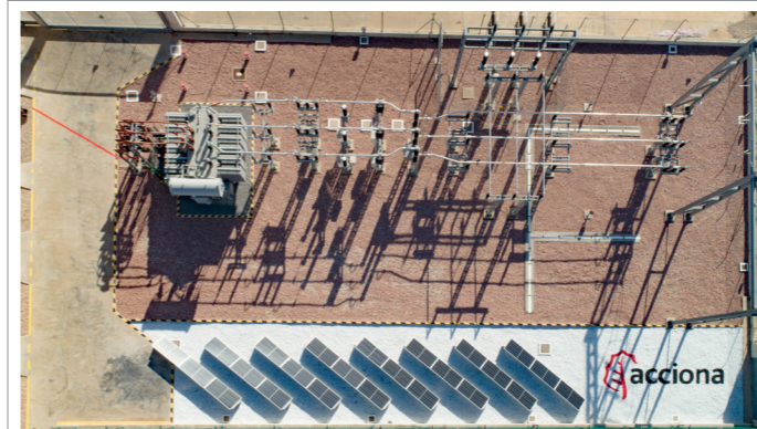
O&M DE LAS INTALACIONES DE AT PARA ACCIONA
