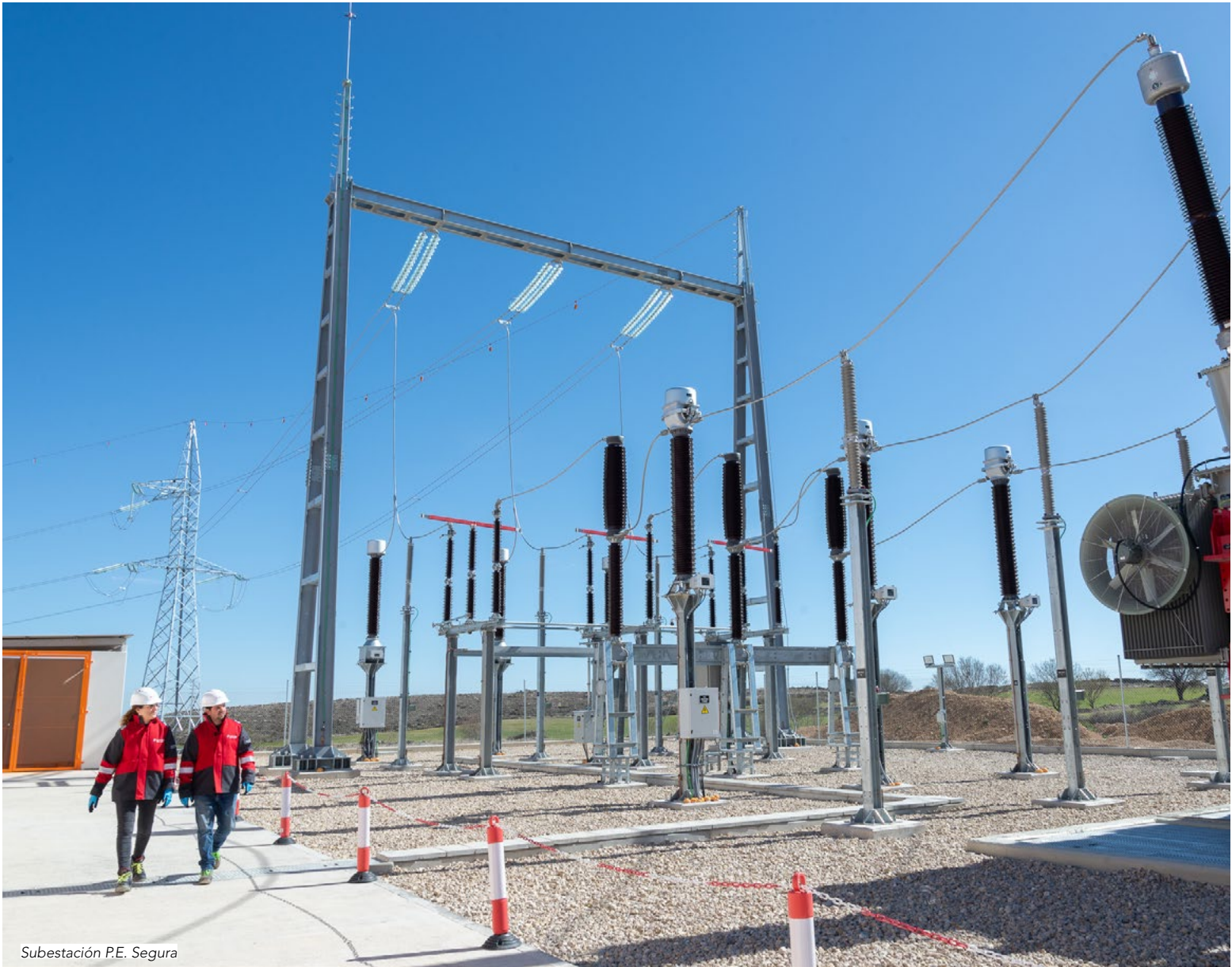
Subestación P.E. Segura
